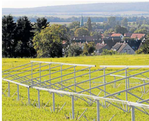
Blick über das Areal der künftigen Photovoltaik-Freiflächenanlage auf Dörnten: Einige Aufsteller für die Solarmodule stehen bereits.
