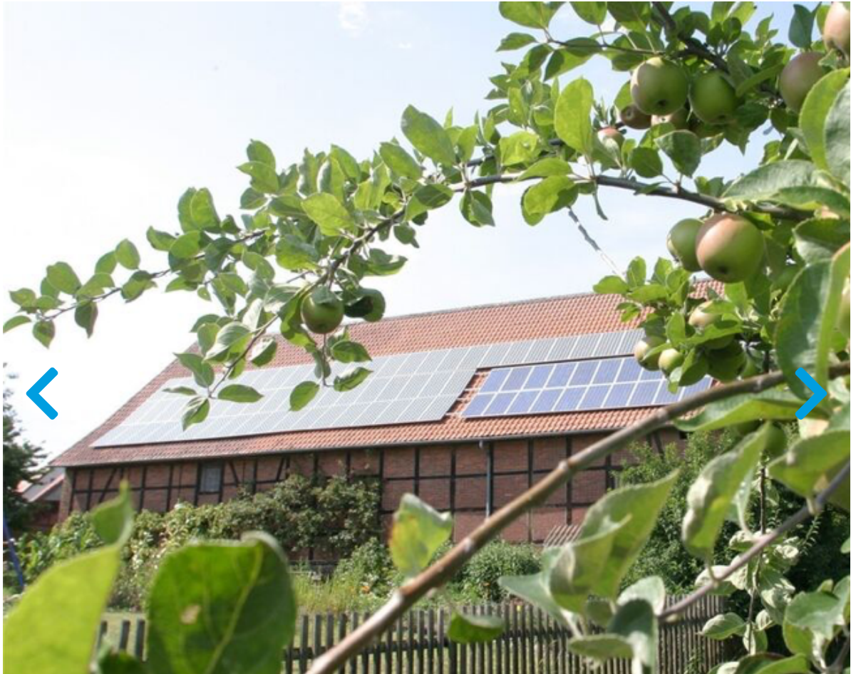
Photovoltaik-Anlage auf einer Scheune in Döhren. Auch im ländlichen Bereich gibt es einige gut nutzbare Flächen Privat
